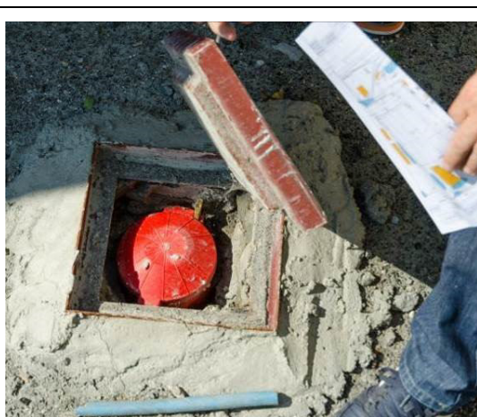
Foto 24 – Piezometro tipo Norton chiuso da lucchetto, installato nel 2014 nel sondaggio S3-Pz-NEW (Img.2.4.12), ubicato nella parte settentrionale del sito, nell'angolo nord-ovest della Centrale Termica.
