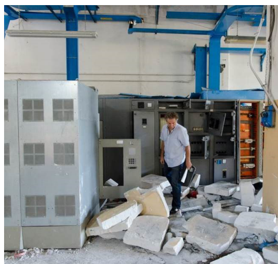
Foto 8 – Cabina di trasformazione elettrica all'interno del locale Fabbricato Lavorazioni (09a).
