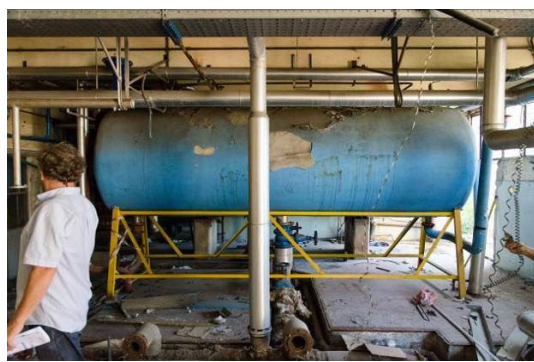
Foto 12 – Locale caldaie all'interno della Centrale Termica (08).
