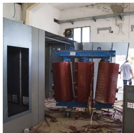
Foto 6 – Locale di trasformazione energia elettrica, trasformatori in resina, situato sul lato nord-est della centrale termica).
