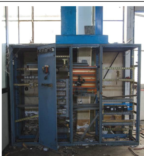
Foto 7 – Cabina elettrica all'interno del locale Ufficio (02a).
